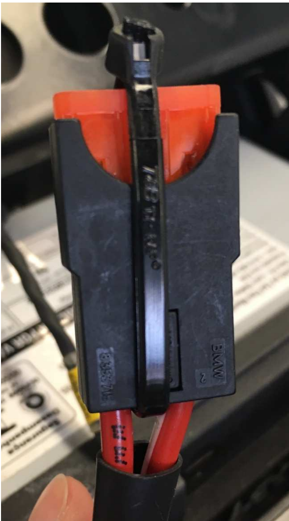
Image 19: Fusible principal sécurisé.
